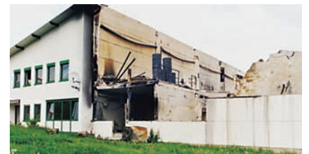
Ein schwerer Brand zerstörte die Stahlhalle. Dank der THERMODUR Brandwand blieb das Bürogebäude unbeschädigt. Suite à un grand incendie dans un bâtiment en acier, seule le bâtiment administratif est resté intact grâce au mur coupe-feu THERMODUR.
