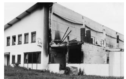
Ein schwerer Brand zerstörte die Stahlhalle. Dank der THERMODUR Brandwand blieb das Bürogebäude unbeschädigt.
